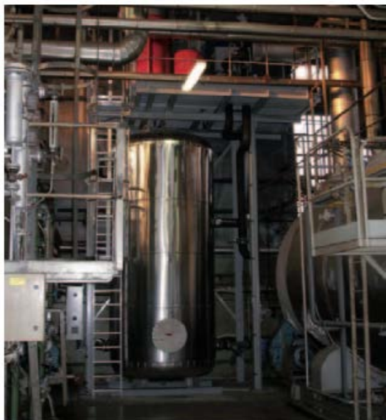
Récupérateur de chaleur installé sur la chaudière
