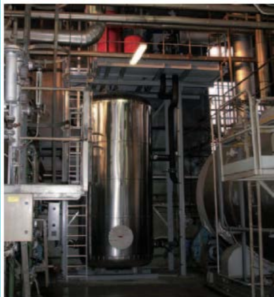
Récupérateur de chaleur installé sur la chaudière
