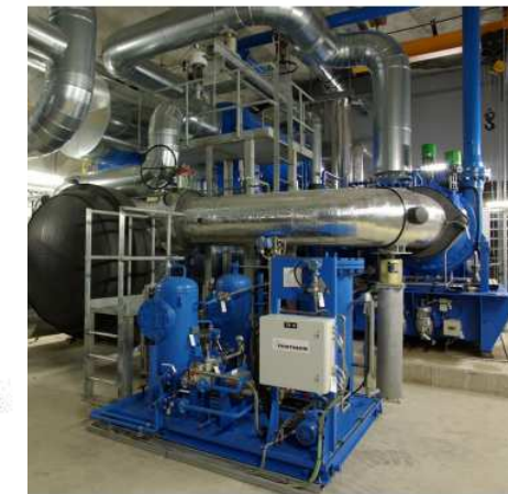
Pompe à chaleur de Katri Vala
